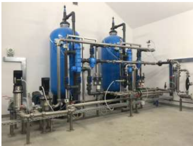
Slika 22: Čistilna naprava za pitno vodo
