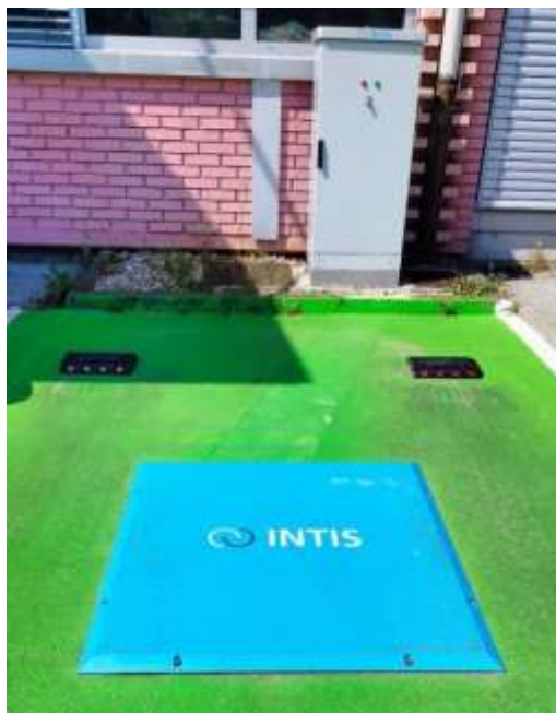
Slika 34: Brezžično polnilno mesto pred PLC Maribor
